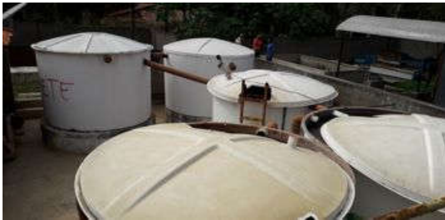
Foto 3.4 – ETE Compacta - Tanques de processo, Tanques Anaeróbios, Tanques de Aeração e de Decantação – Conj. Habitacional Filadélfio Freire Castro no Bairro Meladão
