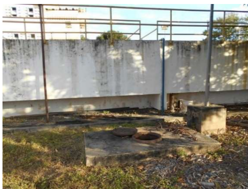
FIGURA 4.29 - POÇO DE VISITA DA DESCARGA DA ETA
