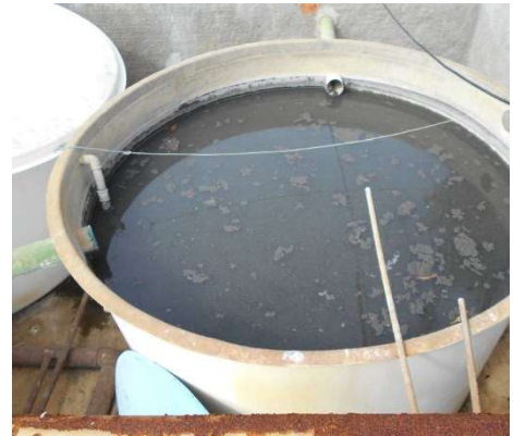
FIGURA 4.77 - TANQUE DE APLICAÇÃO DO HIPOCLORITO DE CÁLCIO DILUÍDO
