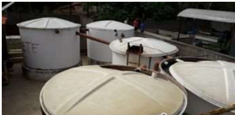
FIGURA 4.75 - VISTA GERAL DOS TANQUES DE PROCESSO, TANQUES ANAERÓBIOS, TANQUES DE AERAÇÃO E DE DECANTAÇÃO
