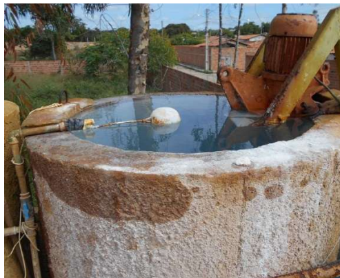
FIGURA 4.78 - TANQUE DE PREPARO DE HIPOCLORITO DE CÁLCIO GRANULADO
