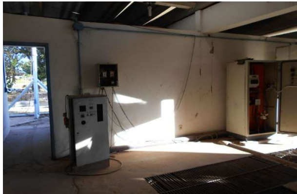
FIGURA 4.25 - PAINÉIS ELÉTRICOS DAS BOMBAS DO RECALQUE AO RESERVATÓRIO ALTO DA GUIA
