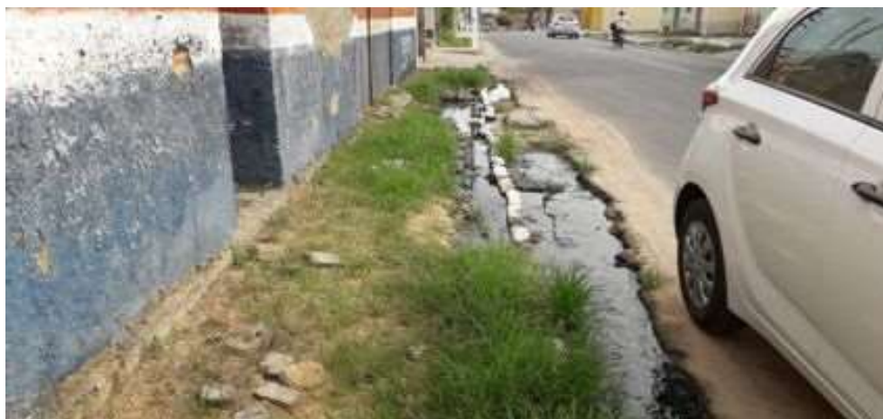
FIGURA 4.60 - TRANSBORDAMENTO DE FOSSA SÉPTICA ESCORRENDO PELA SARJETA – RUA PADRE UCHÔA, BAIRRO CAIXA D'ÁGUA
