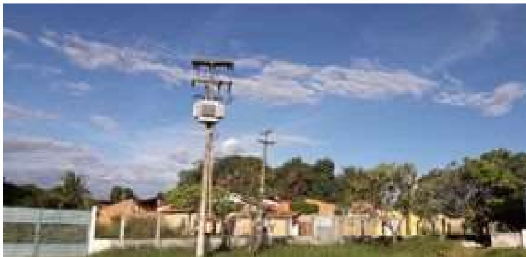
FIGURA 4.34 - TRANSFORMADOR DE ALIMENTAÇÃO DA ETA
