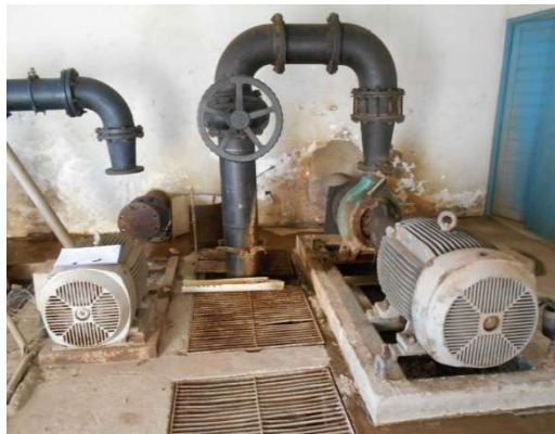
FIGURA 4.23 - CONJUNTO MOTOBOMBA PARA RECALQUE AO RESERVATÓRIO ALTO DA GUIA, SUÇÃO NO RESERVATÓRIO DE ÁGUA FILTRADA DA ETA. INEXISTÊNCIA DE VÁLVULA DE BLOQUEIO NA SUÇÃO
