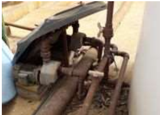
FIGURA 4.82 - BOMBAS CENTRÍFUGAS DO SISTEMA DE PREPARO DE PRODUTOS QUÍMICOS
