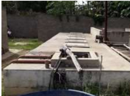
FIGURA 4.73 - CAIXA DE GORDURA E ABERTURA DA BOMBA DE RECALQUE AO TANQUE ANAERÓBIO
