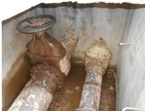
FIGURA 4.38 - TUBULAÇÃO DE ALIMENTAÇÃO ( \varnothing 350\text{MM} ) DO RESERVATÓRIO R 03 – ALTO DA GUIA E SAÍDA PARA DISTRIBUIÇÃO (250MM)
