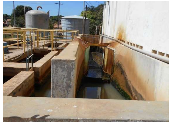
FIGURA 4.13 - VISTA DA CALHA PARSHALL COM ETA FORA DE OPERAÇÃO
