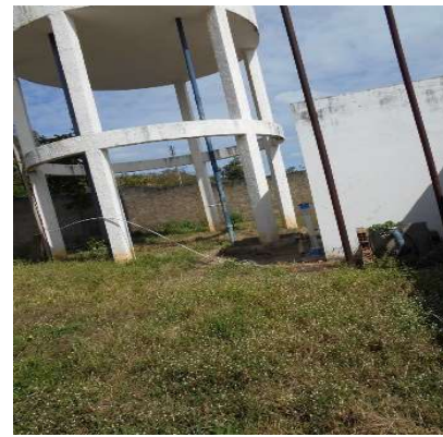
FIGURA 4.52 - POÇO P 05 E RESERVATÓRIO ELEVADO DO CONJUNTO JOSÉ PEREIRA
