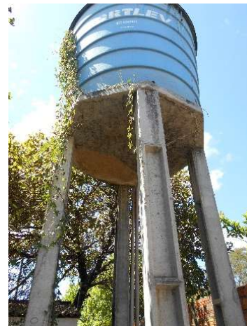
FIGURA 4.48 - RESERVATÓRIO ELEVADO DO POÇO P 03 EM FIBRA DE VIDRO ( V = 15 M^3 ) NO BAIRRO CAJUEIRO II
