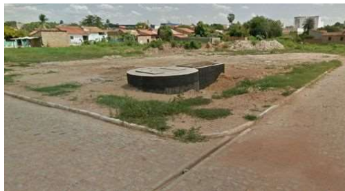
FIGURA 4.61 - ESTAÇÃO ELEVATÓRIA DE ESGOTO EEE 03 NA RUA FERNANDO MARQUES NO BAIRRO BOSQUE SANTA TEREZINHA - POÇO DE SUCÇÃO E CAIXA DE BARRILETE CONSTRUÍDOS. (FONTE DA IMAGEM: GOOGLE EARTH)
