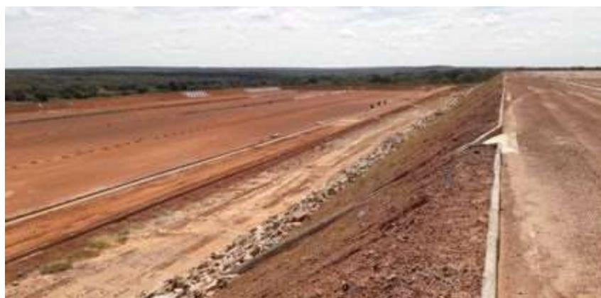
FIGURA 4.68 - VISTA GERAL DA LAGOA DE MATURAÇÃO
