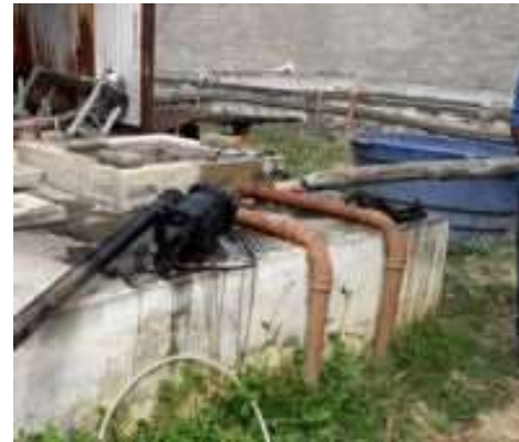
FIGURA 4.74 - BOMBA PARA RECALQUE AO TANQUE ANAERÓBIO COM DEFEITO, SEM BOMBA RESERVA. ETE FORA DE OPERAÇÃO
