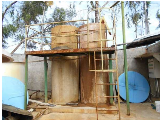
FIGURA 4.80 - PLATAFORMA DE ACESSO AOS TAQUES DE PREPARO DE SOLUÇÃO DE HIPOCLORITO DE CÁLCIO E SULFATO DE ALUMÍNIO DESATIVADO. PLATAFORMA EM AVANÇADO GRAU DE OXIDAÇÃO
