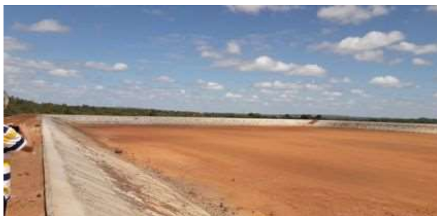
FIGURA 4.67 - VISTA GERAL DA LAGOA FACULTATIVA
