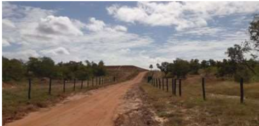
FIGURA 4.65 – ETE FLORIANO - VISTA GERAL DO TALUDE EXTERNO DA LAGOA DE TRATAMENTO DE ESGOTO
