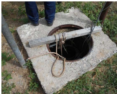
FIGURA 4.71 - ELEVATÓRIA DE ESGOTO PARA A CAIXA DE GORDURA
