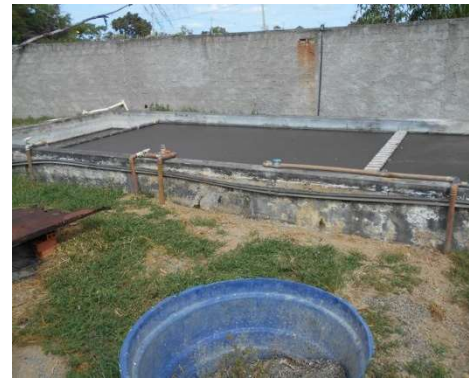
FIGURA 4.83 - TANQUE DE DECANTAÇÃO APLICAÇÃO DE HIPOCLORITO E SAÍDA PARA LANÇAMENTO NO CORPO RECEPTOR
