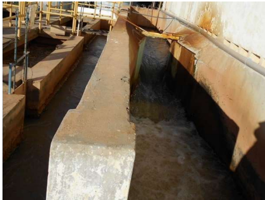
FIGURA 4.11 - CHEGADA DE ÁGUA BRUTA, CALHA PARSHALL E APLICAÇÃO DE COAGULANTE
