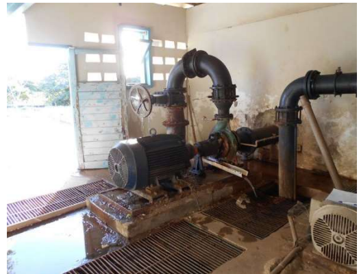
FIGURA 4.24 - CONJUNTO MOTOBOMBA RESERVA PARA RECALQUE AO RESERVATÓRIO ALTO DA GUIA COM VAZAMENTO PELA GAXETA, INEXISTÊNCIA DE VÁLVULA DE BLOQUEIO NA SUÇÃO
