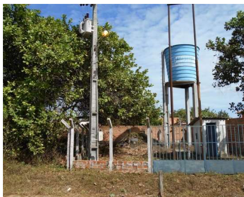
FIGURA 4.44 - POÇO P 01 E RESERVATÓRIO ELEVADO EM FIBRA DE VIDRO (V=10 M 3 ) NO BAIRRO MELADÃO
