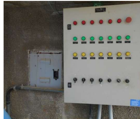
FIGURA 4.81 - QUADRO DE COMANDO DOS MOTORES DO SISTEMA DE PREPARO DE PRODUTOS QUÍMICOS
