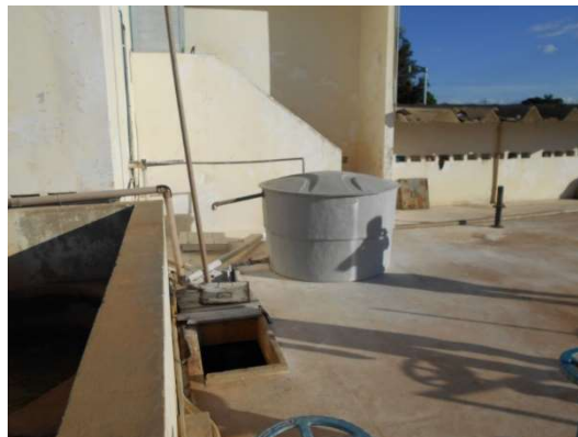
FIGURA 4.20 - PONTO DE APLICAÇÃO DE CAL E HIPOCLORITO DE SÓDIO NO TANQUE DE ÁGUA FILTRADA
