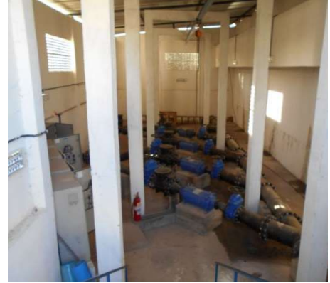
FIGURA 4.32 - CONJUNTOS MOTOBOMBA (1+1R) DOS SISTEMAS ETA-PLANALTO BELA VISTA (MORRO DO TIRO) E PLANALTO SAMBAÍBA
