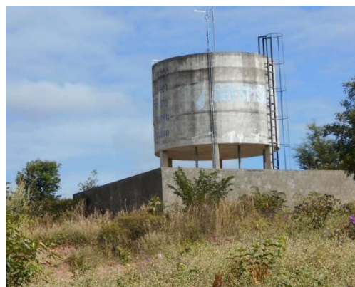
FIGURA 4.56 - RESERVATÓRIO EM CONCRETO V=100M^3 DO CONJUNTO HABITACIONAL FILADÉLFIO FREITAS CASTRO. RECEBE VAZÃO DOS POÇOS P 07, P 08 E P 09
