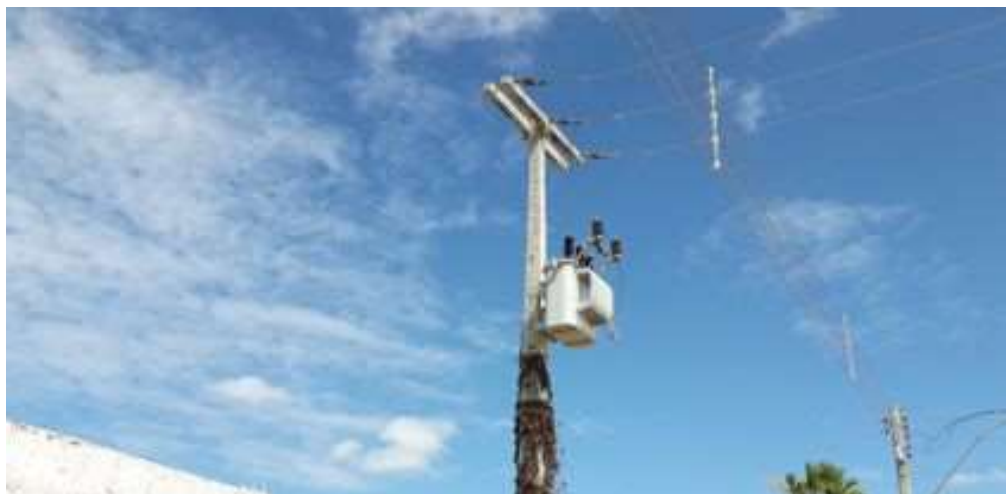
FIGURA 4.63 - TRANSFORMADOR PARA ALIMENTAÇÃO ELÉTRICA DA EEE 03 – RUA FERNANDO MARQUES, ALTURA DO Nº 131
