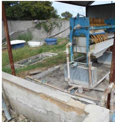
FIGURA 4.84 - FILTRO PRENSA PARA DESIDRATAÇÃO DE LODO DESATIVADO
