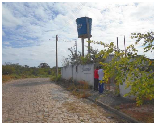
Figura 4.53 - Poço P 06 e reservatório elevado V=10m^3 da Vila Caiçara
