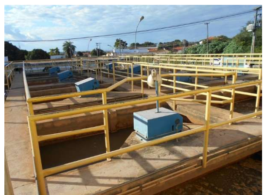
FIGURA 4.14 - FLOCULADORES (4 TANQUES C/3 AGITADORES)
