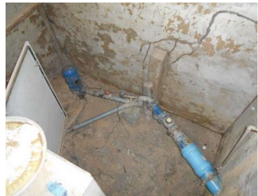
FIGURA 4.39 - BOMBA CENTRÍFUGA PARA PRESSURIZAÇÃO DA REDE DO BAIRRO NOSSA SENHORA DA GUIA, ALIMENTADA PELA BOMBA SUBMERSÍVEL INSTALADA NO RESERVATÓRIO R 03
