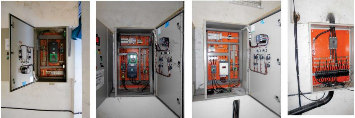
FIGURA 4.33 - PAINÉIS ELÉTRICOS DOS SISTEMAS DE RECALQUE ETA-PLANALTO BELA VISTA E ETA-PLANALTO SAMBAÍBA
