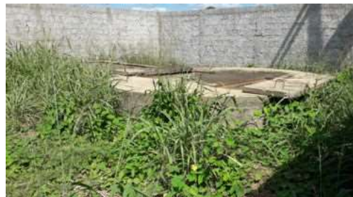
FIGURA 4.62 - SITUAÇÃO ATUAL DA ESTAÇÃO ELEVATÓRIA DE ESGOTO EEE 03 COM MURO DE FECHAMENTO EXECUTADO E SEM INSTALAÇÃO HIDROMECÂNICA E ELETROMECÂNICA
