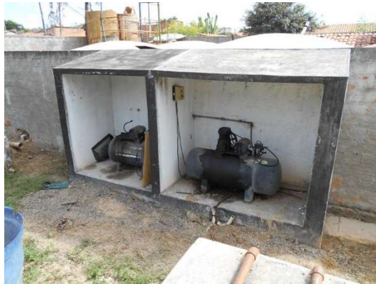
FIGURA 4.76 - COMPRESSORES PARA AERAÇÃO DOS TANQUES
